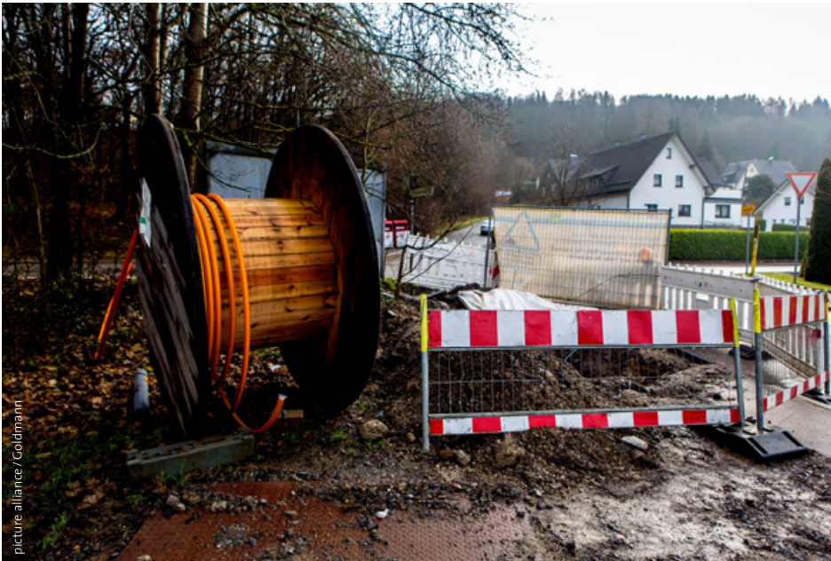
Eine wichtige Voraussetzung, um die Lebensqualität in ländlichen Räumen zu verbessern, ist eine wohnortnahe, moderne Infrastruktur; dazu gehört der Breitbandausbau für schnelles Internet. Im nordrhein-westfälischen Nümbrecht wird im Dezember 2019 ein Glasfasernetz verlegt.
