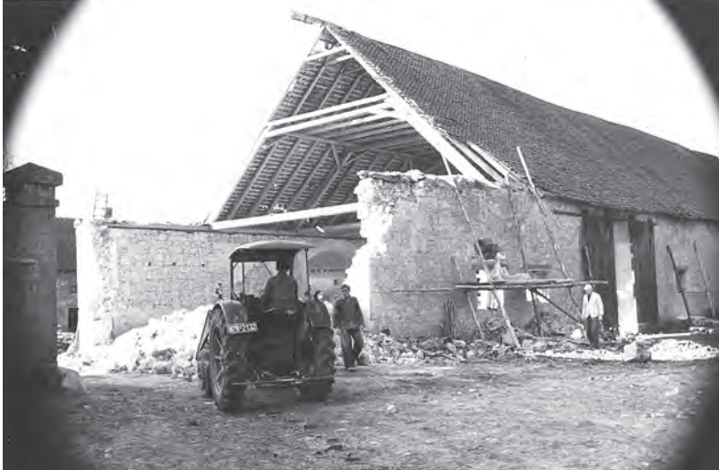
Abbildung 34: Umbau des Rittergutes Lucklum bei Braunschweig. Das Institut für landwirtschaftliche Bauforschung brachte Forschungsergebnisse in die Modernisierung ein.
