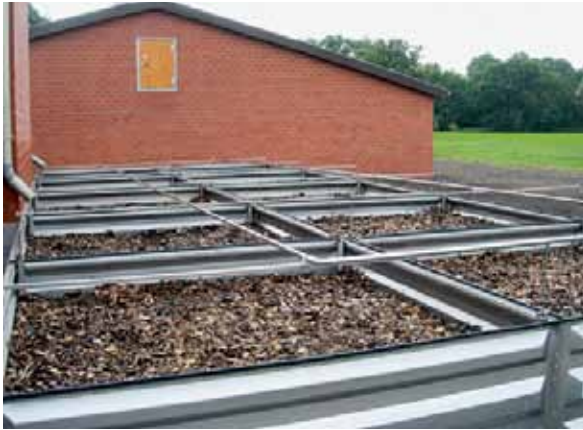
Abb. 2: Blick auf einen einstufigen Biofilter zur Reinigung von Abluft aus Schweinehaltungen
