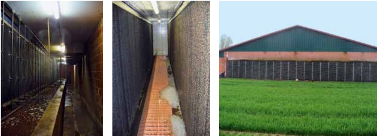
Abb. 4a-c: Beispiel für eine mehrstufige Abluftreinigungsanlage mit Rohgaseintritt in den Vorraum (links), zwei Füllkörperwänden (Mitte) und Biofilter als finale Reinigungsstufe (rechts)
