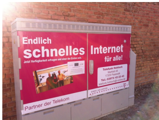
Abbildung 12: Aktiver Kabelverzweiger nach Breitbandausbau in Glasow
